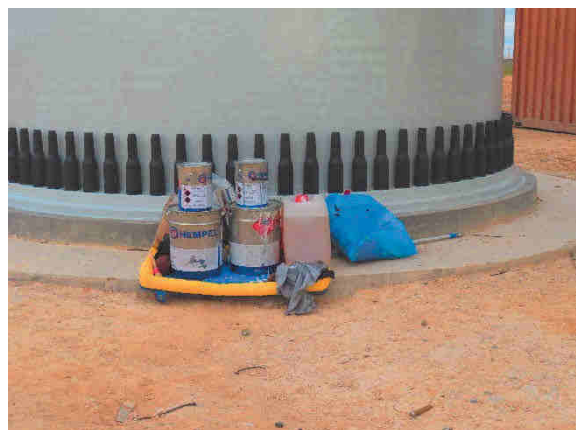
Productos peligrosos sobre cubetos antivertidos.
