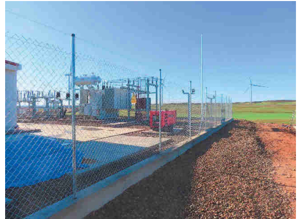
Vallado exterior de la SET pendiente de instalar balizas anticolidión para aves.
