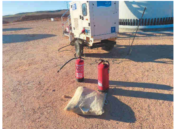
Extintores y mantas antivertidos.
