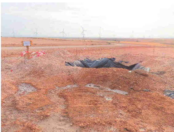
Pozo de lavado junto a la SET.
