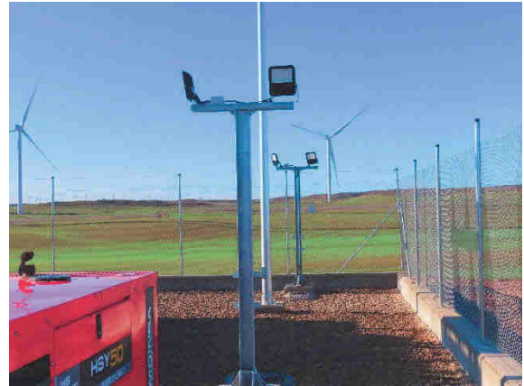
Iluminación exterior de la SET con focos orientables.
