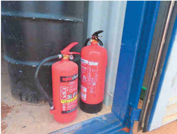
Extintores en punto limpio de Siemens-Gamesa.
