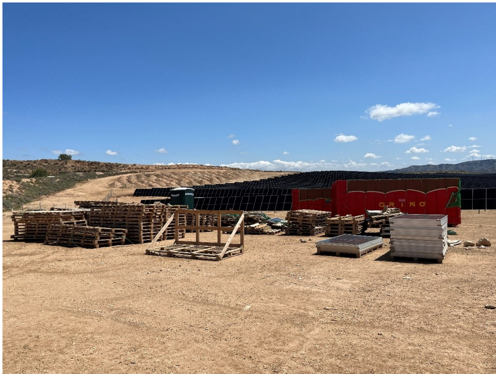
Figura 9 Punto limpio de residuos no peligrosos dispuesto dentro de la planta
