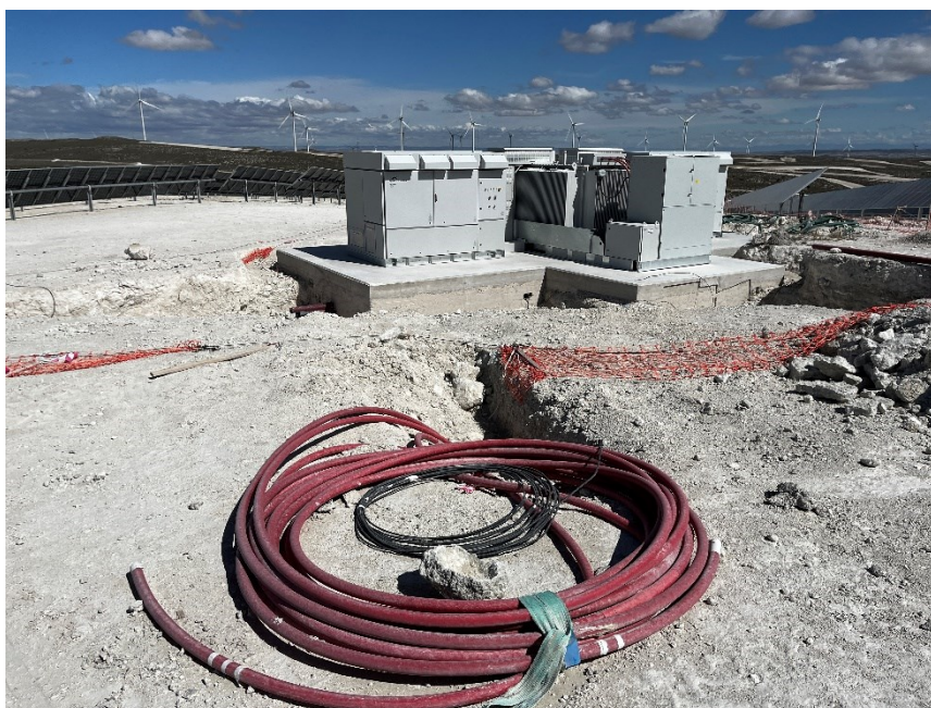
Figura 2 Cableado de los CT
