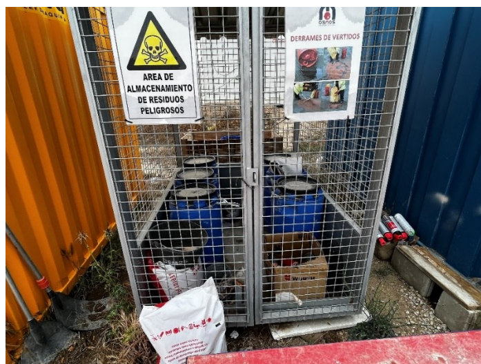
Figura 3 Punto limpio de residuos peligrosos
