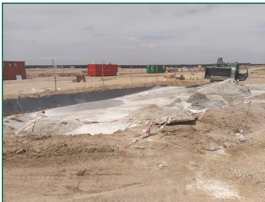
Fotografía 8. Zona de lavado de hormigón.
