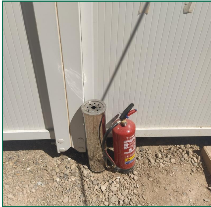
Fotografía 14. Extintor zona exterior.
