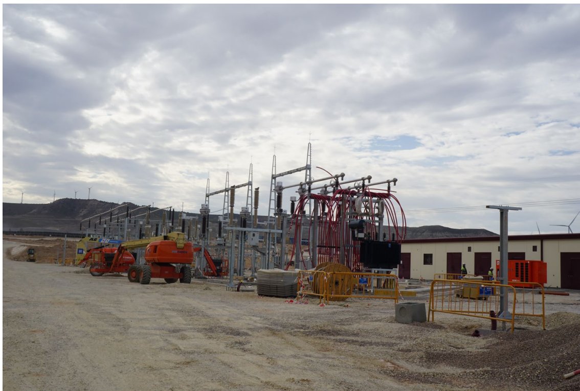
Figura 2b Situación de la subestación eléctrica Vallobar, segunda quincena de mayo
