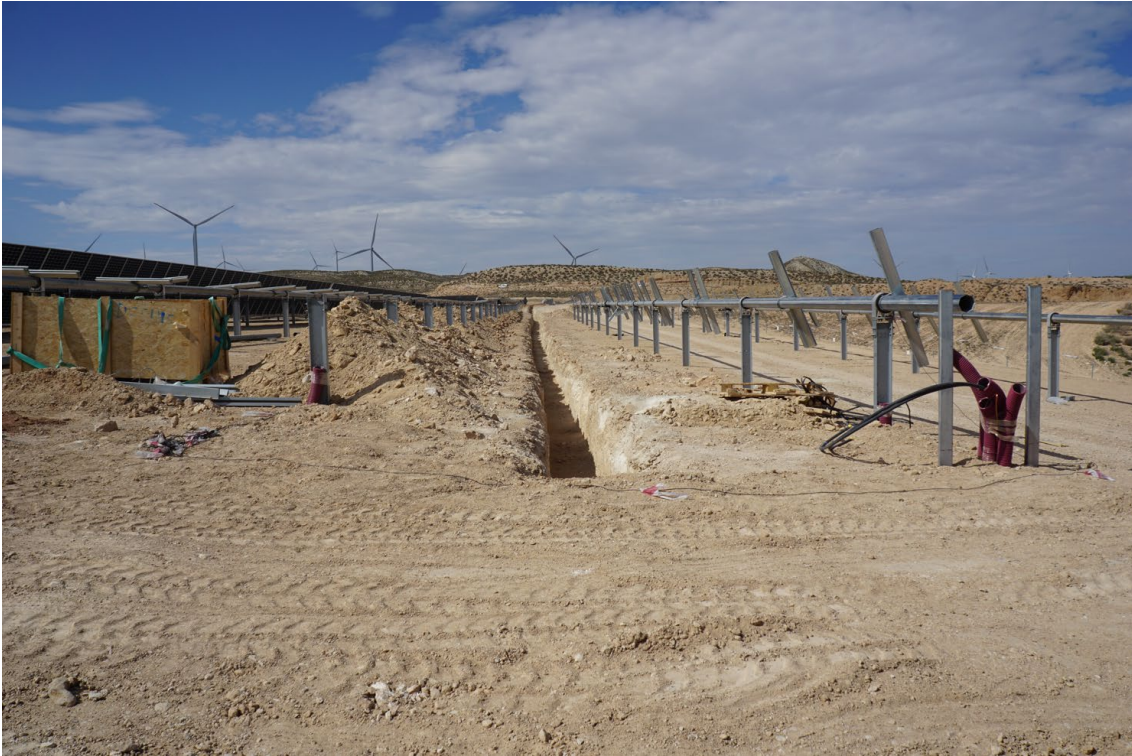
Figura 2c Hileras de placas sin montar a la espera de trabajos de red eléctrica
