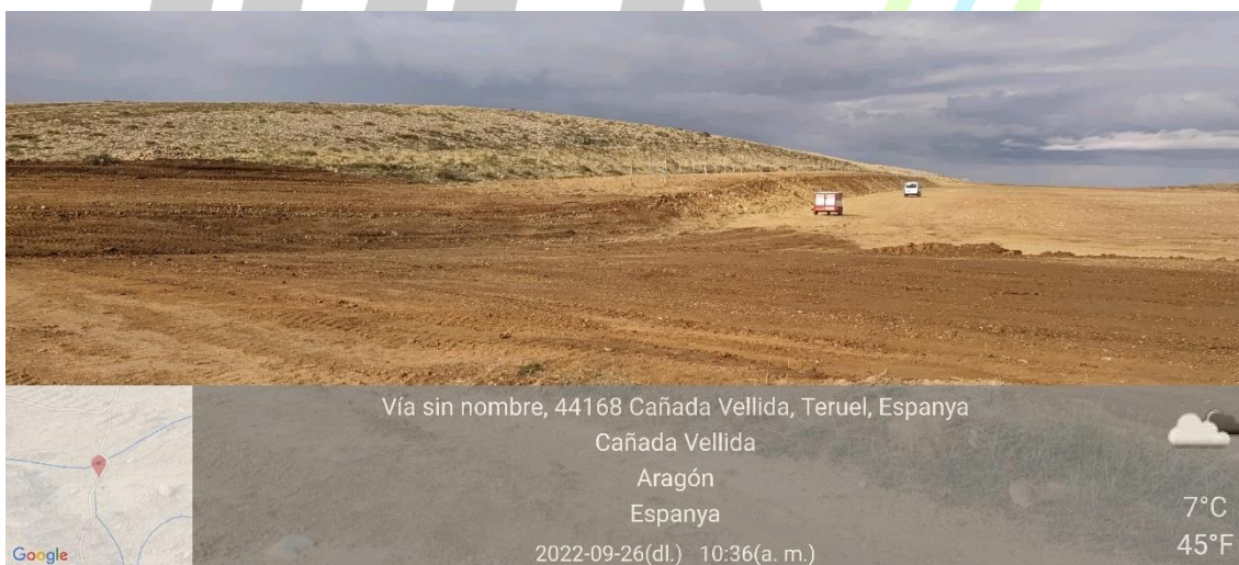
Ilustración 14. Encharcamiento de la zona 5 corregido de forma correcta.
