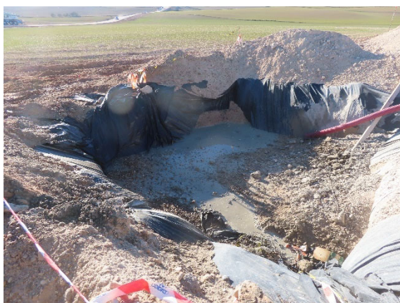
Pozo de lavado de hormigoneras, junto a la SET.
