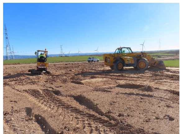
Acondicionamiento de la zona donde estaba el pozo de lavado de las hormigoneras.
