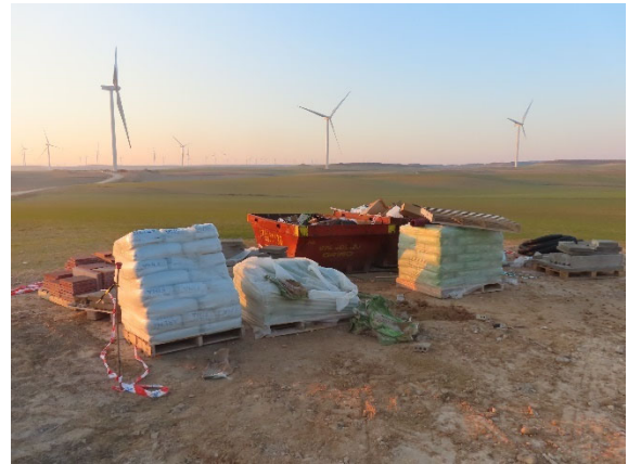
Acopio de materiales junto a la SET.
