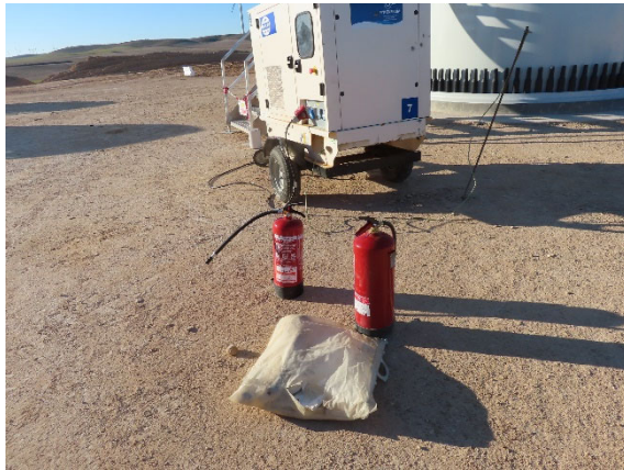
Extintores y manta absorbente para proteger el suelo en las labores de repostaje del grupo electrógeno.
