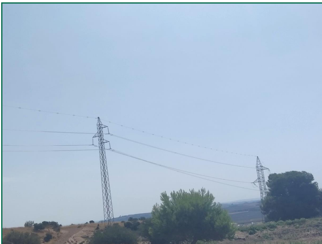
Fotografía 3. Línea eléctrica con balizas salvapájaros
