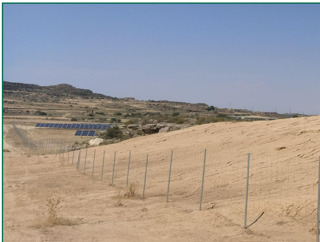
Fotografía 1. Erosión en un talud.
