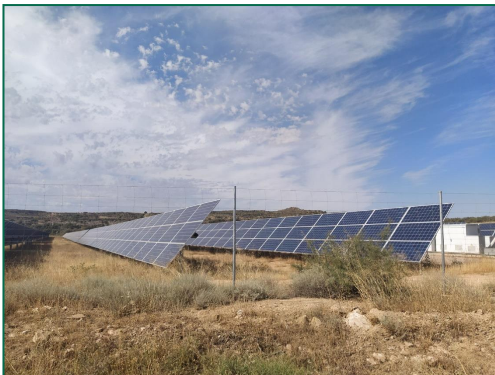
Fotografía 2. Vegetación entre placas a finales de junio.
