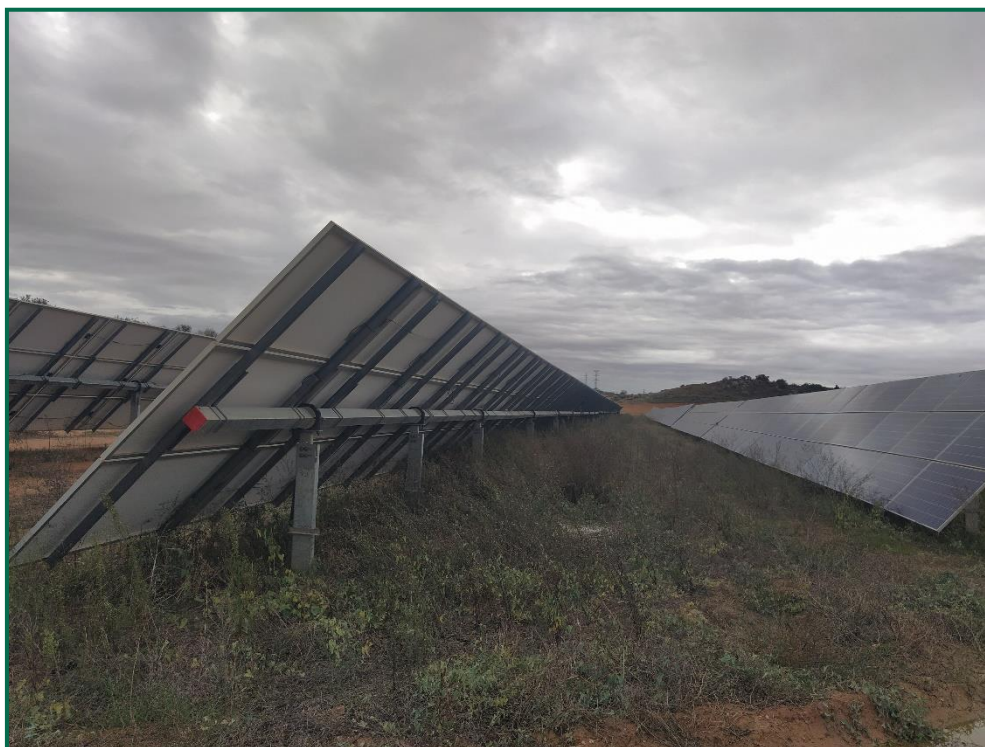
Fotografía 1. Vegetación entre placas actualmente.
