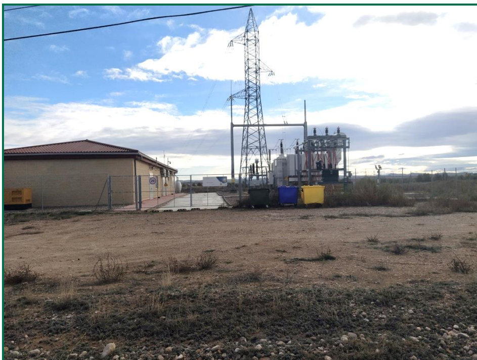
Fotografía 5. Contenedores para residuos en la SET.
