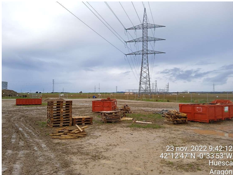
Imagen14.- Punto limpio de Residuos no peligrosos.
