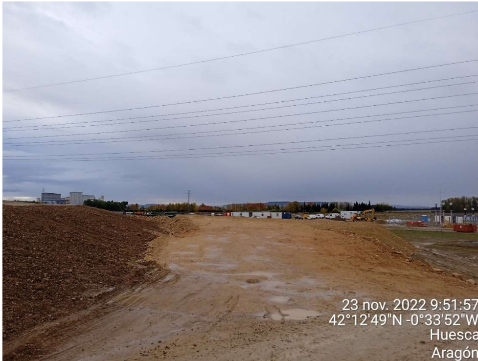
Imagen 3. A la izquierda se aprecia un talud con su capa de tierra vegetal. Al fondo, la zona de instalaciones auxiliares
