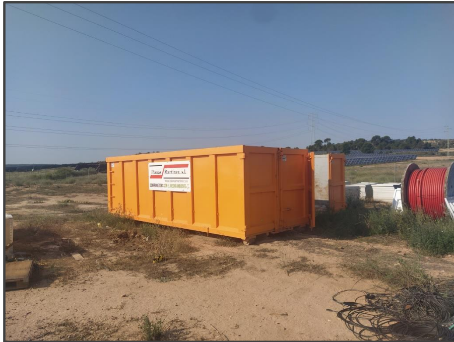
Fotografía 12. Contenedores de residuos.
