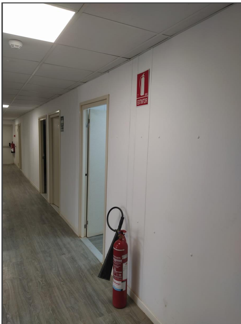
Fotografía 14. Extintores en edificio de control.
