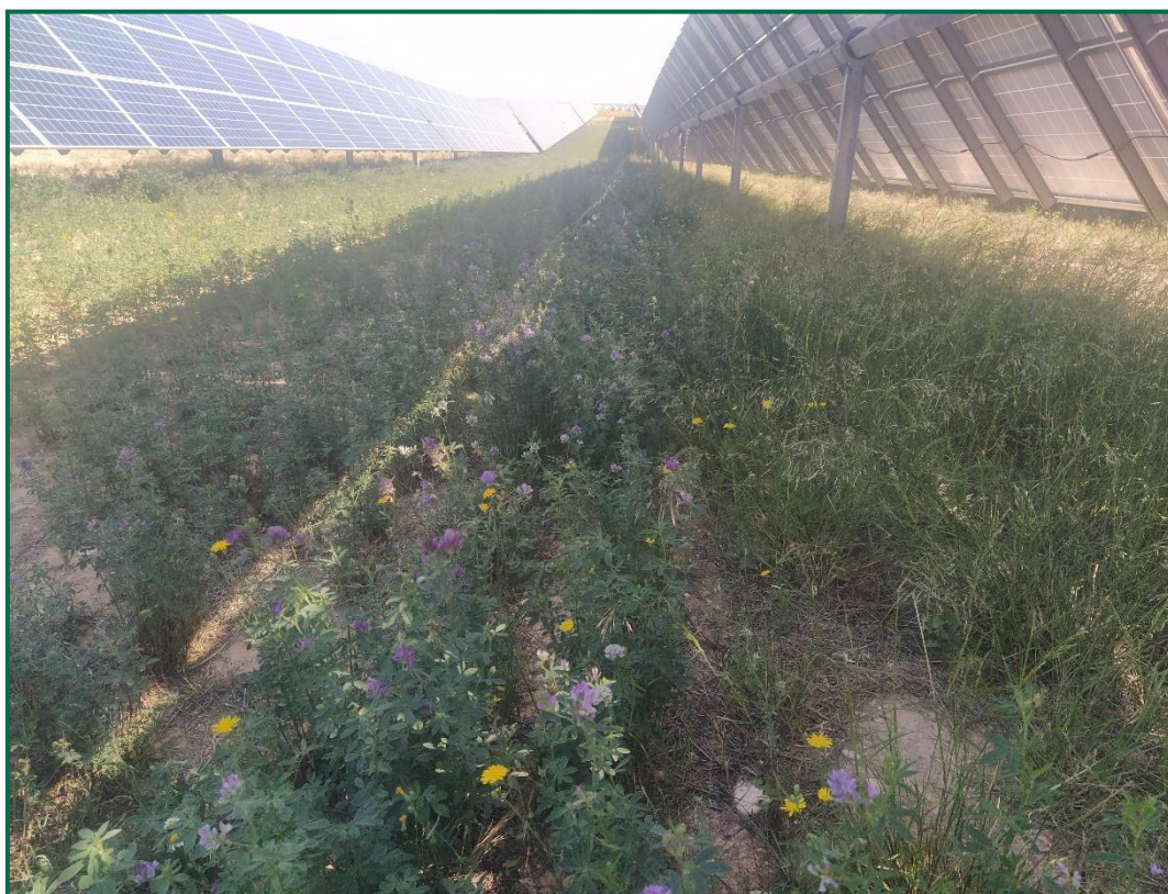
Fotografía 1. Vegetación entre placas en su estado actual.
