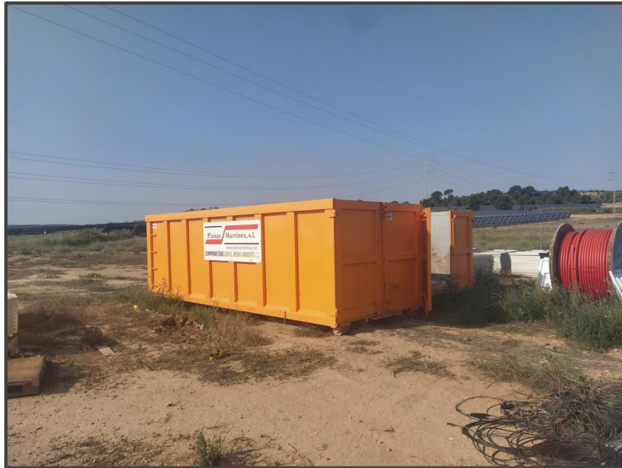
Fotografía 12. Contenedores de residuos.
