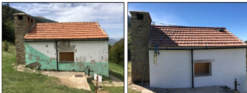
Fachada lateral izquierda del refugio antes y después de los trabajos de acondicionamiento.
