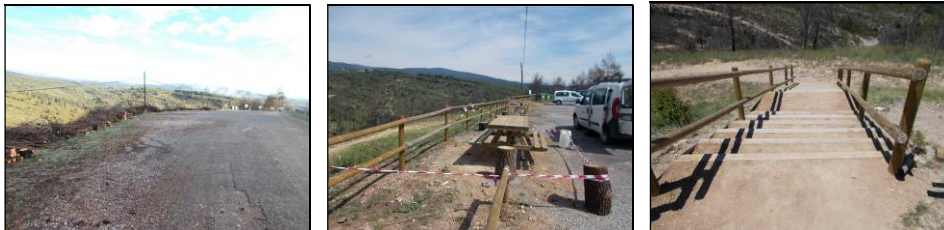
Reconstrucción del aparcamiento del Vero que se quemó en el incendio forestal de Lecina en 2016.
