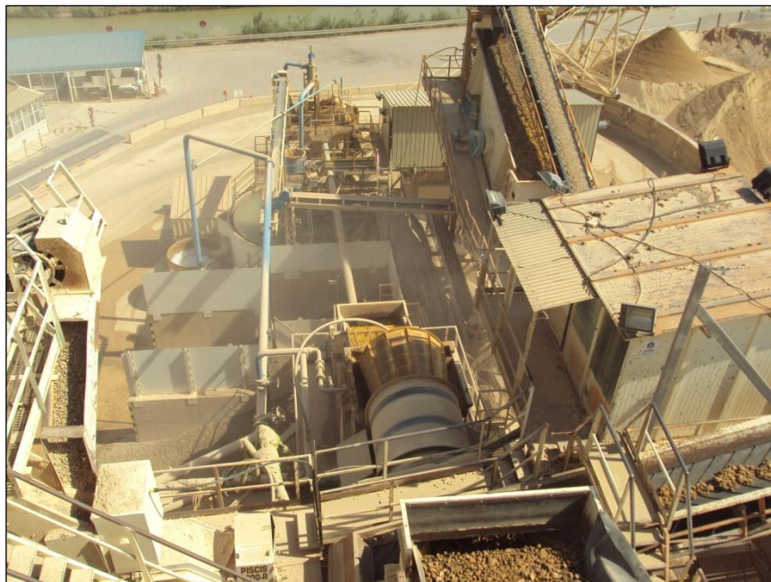
Vista parcial de las instalaciones de tratamiento.
