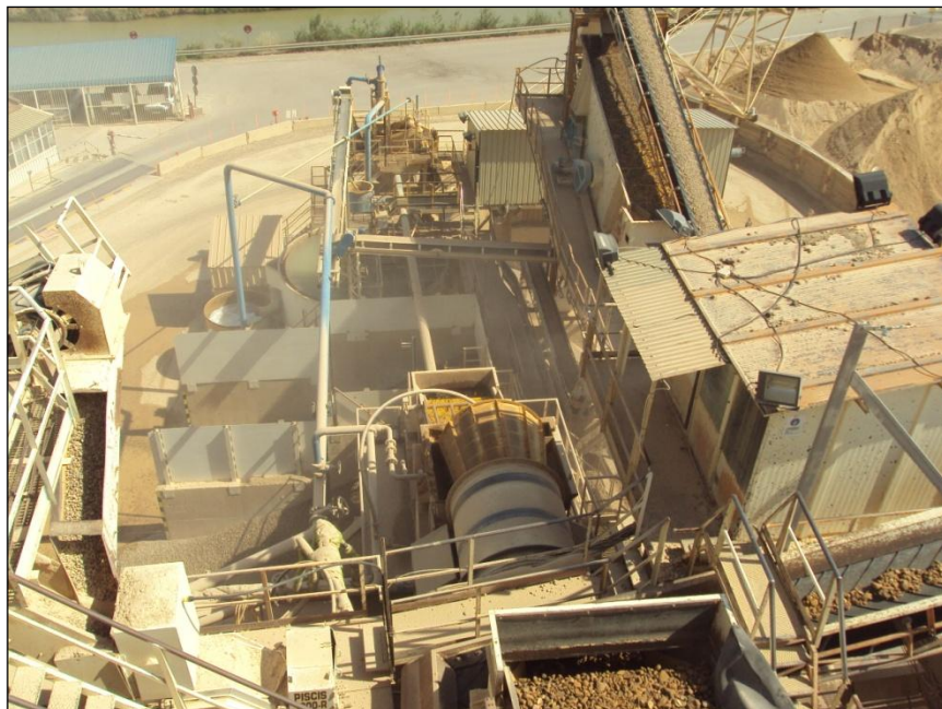
Vista parcial de las instalaciones de tratamiento.
