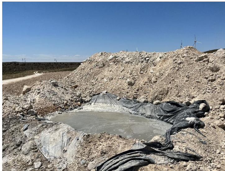
Figura 5 Lavadero de cubas de la SET Fuentes
