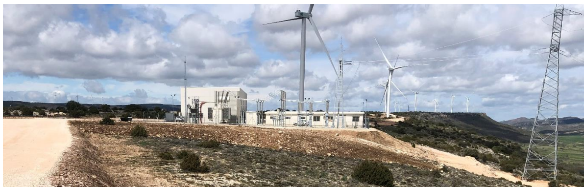
Figura 1: Vistas de la subestación
