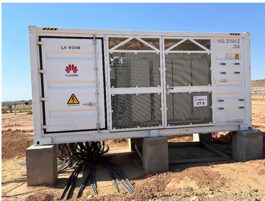
Figura 2 Cableado de los CT
