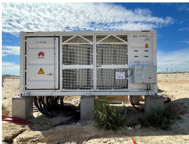
Figura 2 Centro de transformación
