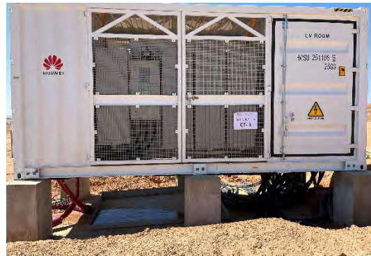
Figura 12 Cableado de los centros de transformación
