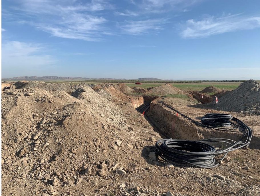
Figura 3 Cableado de la RMT
