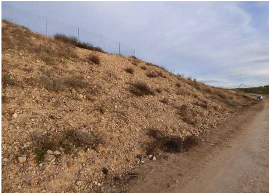
Imagen 1: Talud exterior afectado meses atrás por procesos erosivos. En la actualidad la nascencia de las especies hidrosebradas es irregular. No se han detectado signos de erosión en la superficie del talud (regueros, cárcavas, etc.)
