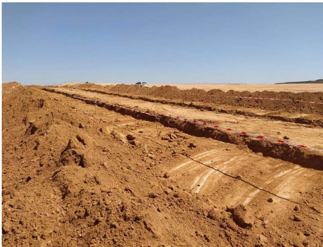
Foto 3. Balizado de las estructuras negativas localizadas en las zanjas de Baja tensión en zona 4 de la PSFV Pitarco B.
