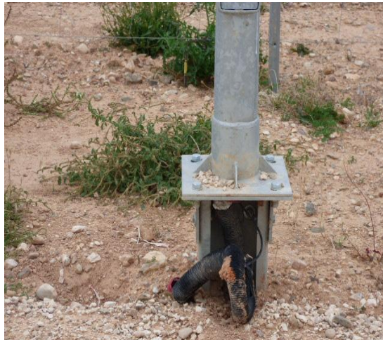
Imagen 11: Cableado en una de las columnas donde se ubica la cámara de vigilancia.
