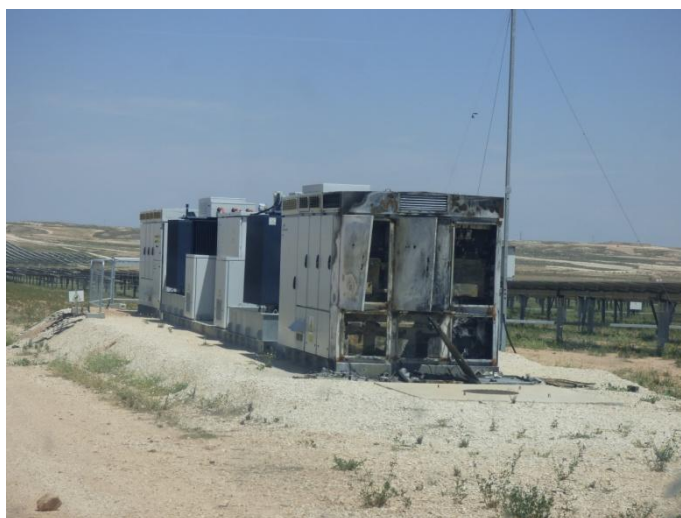
Imagen 25: Foto del inversor dañado.
