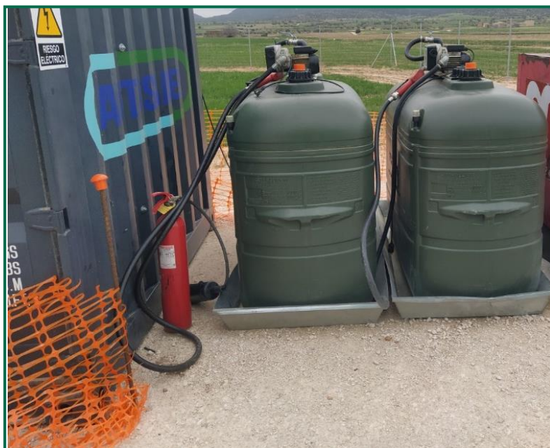
Fotografía 11. Extintor junto a contenedores de combustible.
