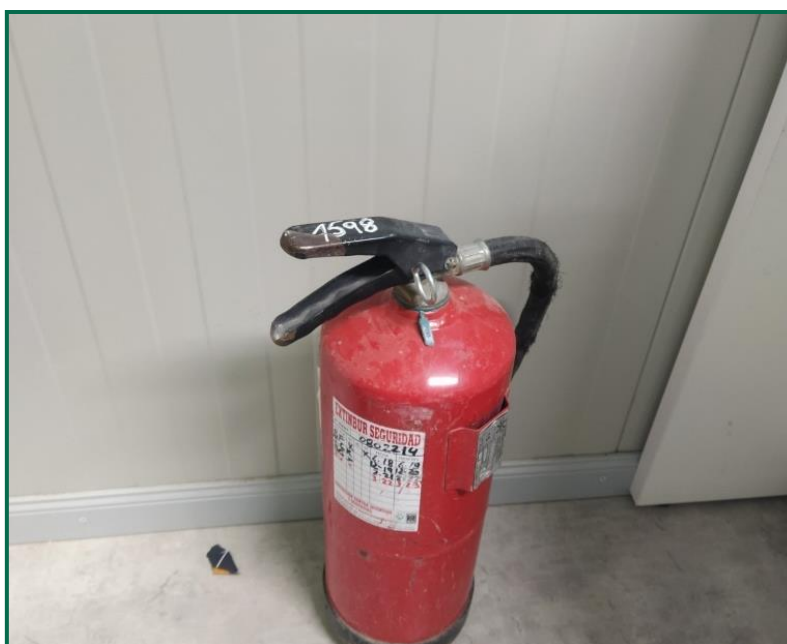
Fotografía 12. Extintor en el interior de las oficinas.
