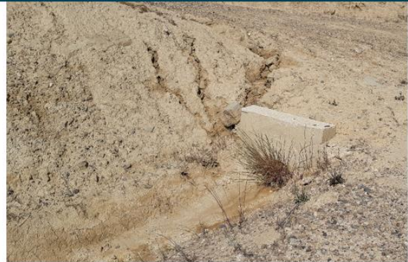
Fig. 2 Tubo de drenaje taponado por vegetación arbustiva y sedimentos
