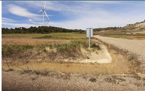
Fig. 1 Encharcamiento en margen de plataforma del aero ML5.09.
