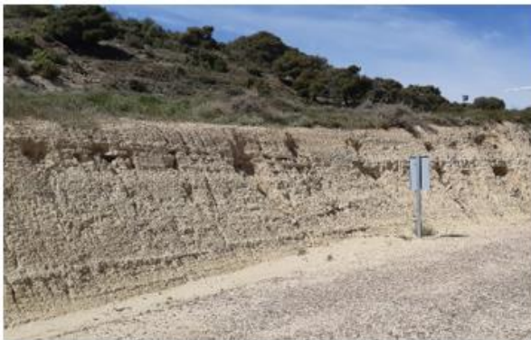
Fig. 3 Erosión hídrica en materiales margosos del talud de desmonte de plataforma del aereo ML5.05. Fuente: Elaboración propia
