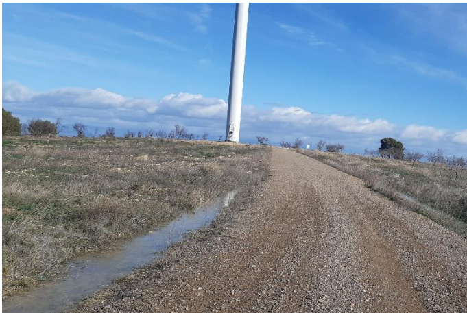
Fig. 3 Encharcamiento en margen de vial de acceso al aero ML4.02.
