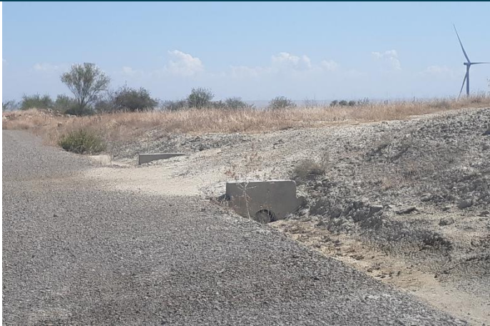
Fig. 1 Tubo de drenaje semitaponado con sedimentos en vial de acceso al aero ML4.07. Fuente: Elaboración propia
