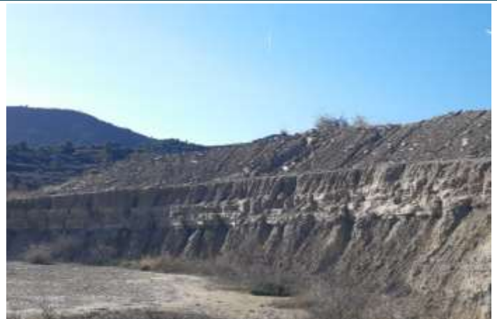
Fig. 2 Erosión hídrica en materiales margosos del talud de desmonte de la plataforma del aero ML4.05. Fuente: Elaboración propia
