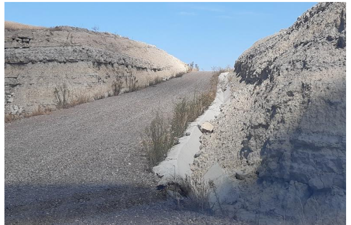
Fig. 4 Cuneta llena de sedimentos en vial de acceso al aero ML4.05.
