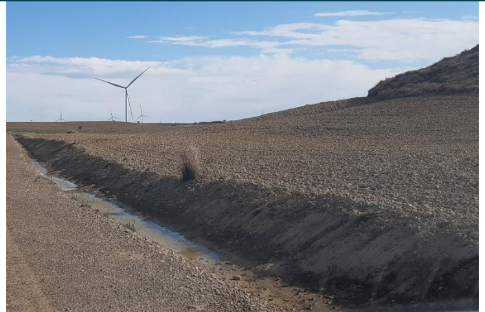
Fig. 2 Encharcamiento en margen de plataforma del aero ML2.05.
