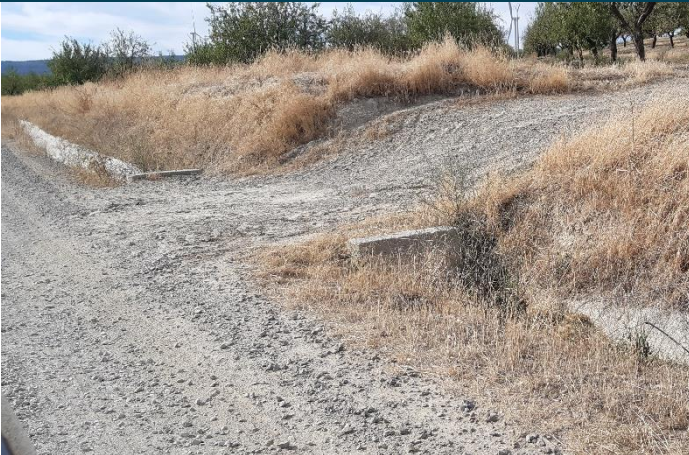
Fig. 1 Tubo de drenaje semitaponado con vegetación arbustiva en vial de acceso al aero ML2.14. Fuente: Elaboración propia
