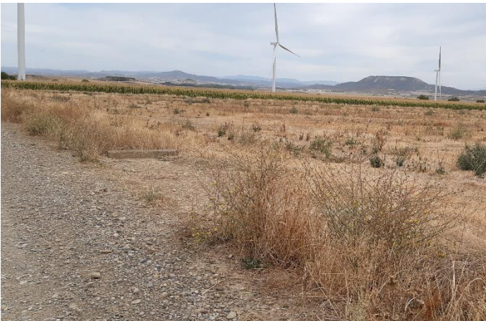
Fig. 3 Tubo de drenaje taponado por vegetación arbustiva en vial de acceso al aero ML2.06. Fuente: Elaboración propia
