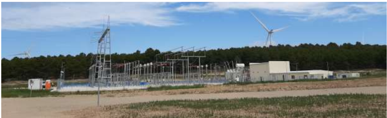
Figura 1: Vistas de la subestación Cañaseca.
