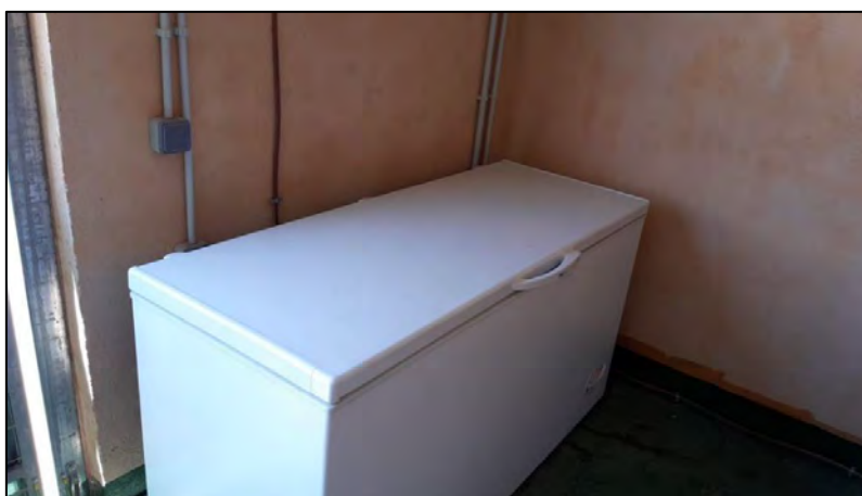
Fotografía 1. Arcón congelador del parque eólico
