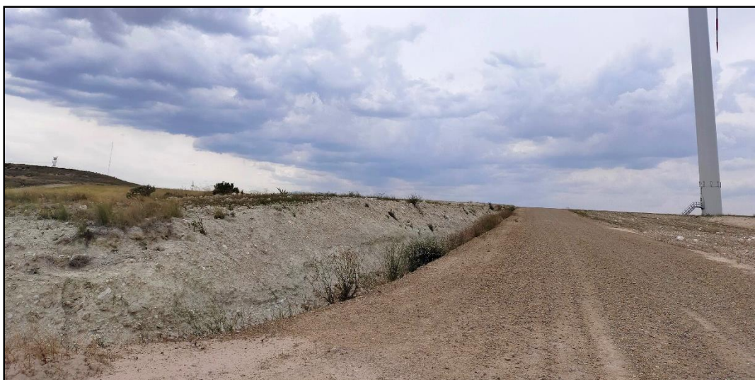
Fotografía 2. Talud desprovisto de vegetación.
