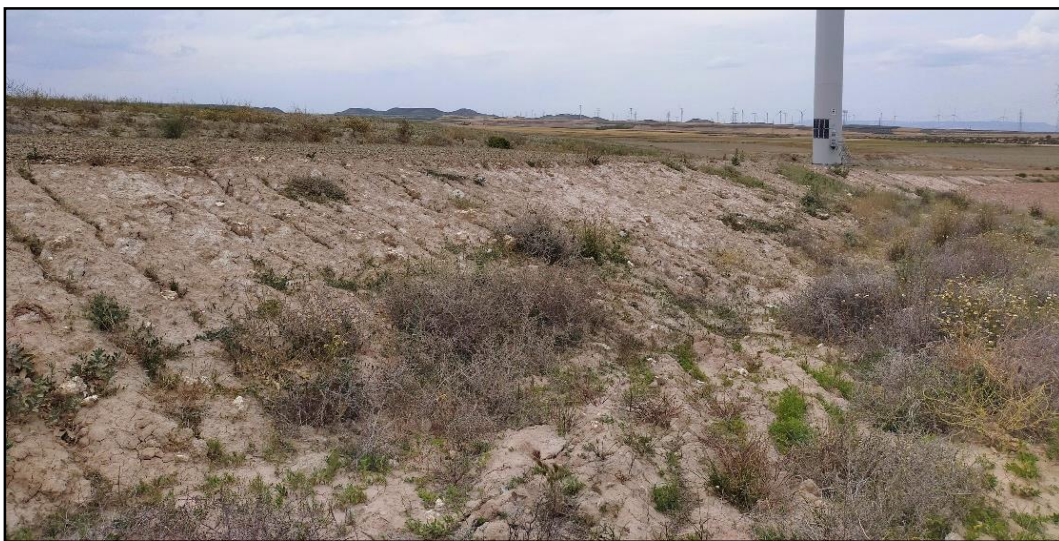
Fotografía 1. Pequeños regueros en el talud del aerogenerador HE-03.
