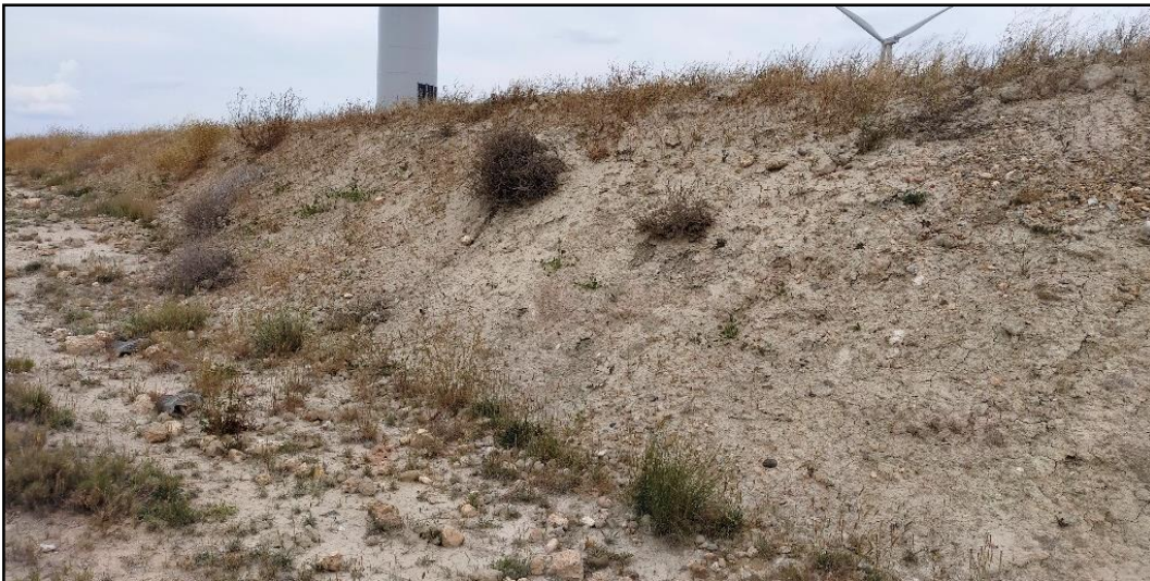
Fotografía 8. Aspecto del talud junto a HE-04
