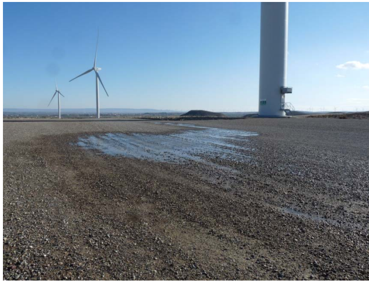
Foto 7. Pequeña acumulación de agua en la plataforma de LE-03
