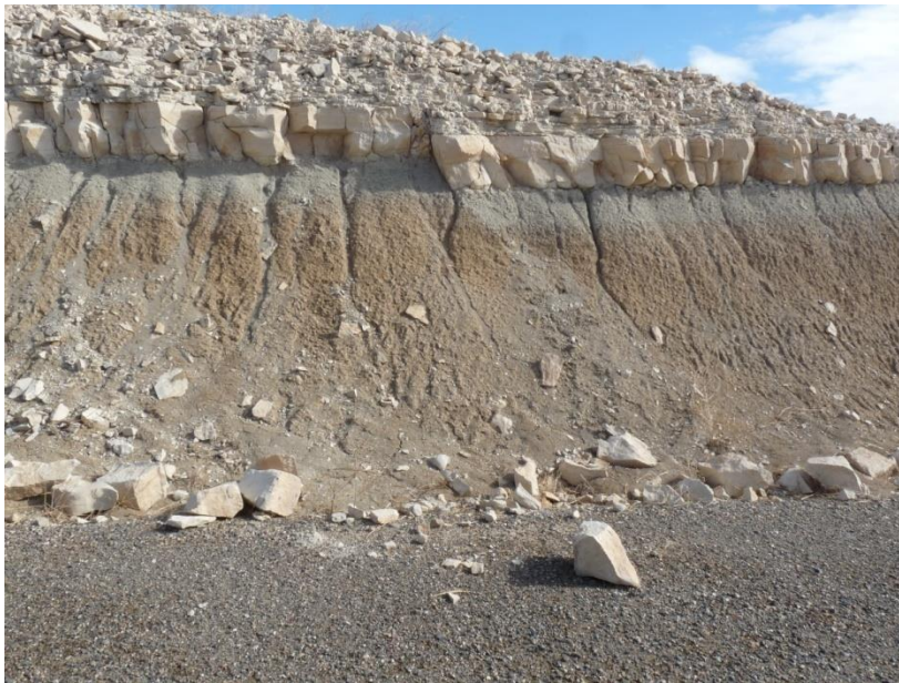
Foto 4. Desprendimientos de bloques sobre la plataforma de DM-01
