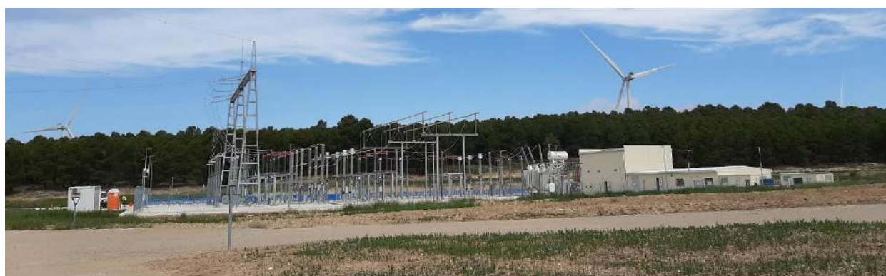
Figura 1: Vistas de la subestación Cañaseca.
