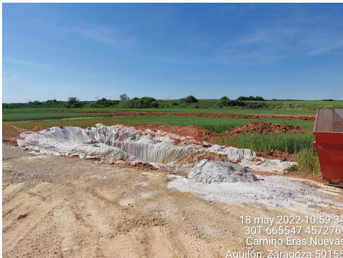
Imagen 1. Residuo de hormigón evidente en pozo de lavado SB1-7.
