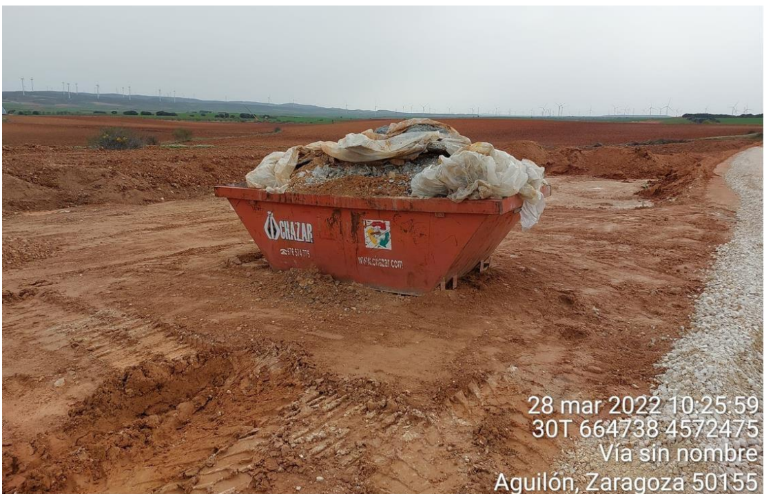
Imagen 3. Contenedor móvil que se debe vaciar en cuanto puedan acceder los camiones.
