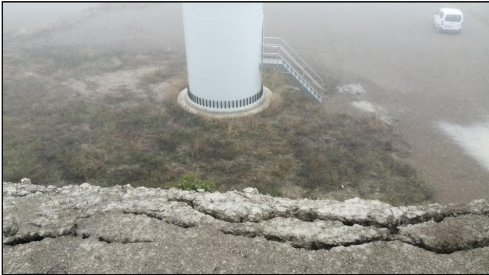
Fotografía 4. Pequeño deslizamiento en el talud del aerogenerador LP-10.
