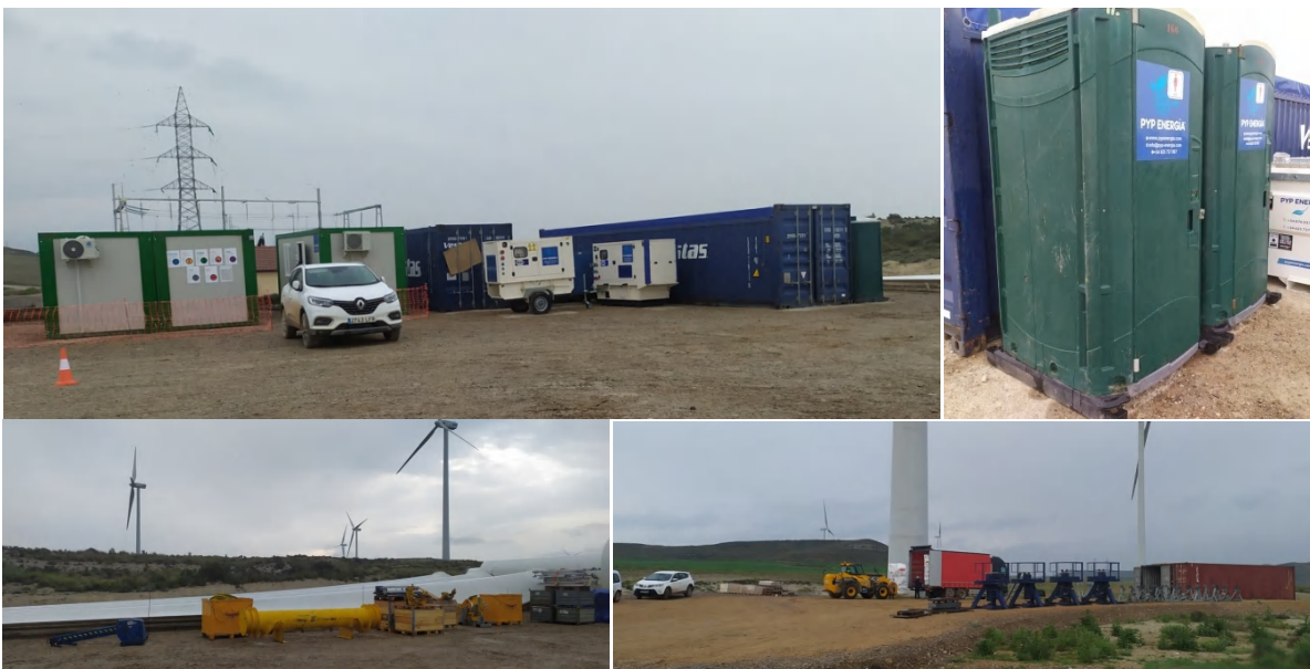
Foto 3. Conjunto de fotografías que muestran el nuevo Site Camp establecido por Vestas durante la fase de montaje de aerogeneradores, mostrándose las casas de contratas, grupos electrógenos, servicios portátiles, contenedores metálicos de almacenaje y aparcamientos de vehículos.
