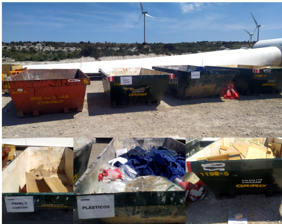
Foto 18. Contenedores de residuos no peligrosos durante la fase de montaje de los aerogeneradores.
