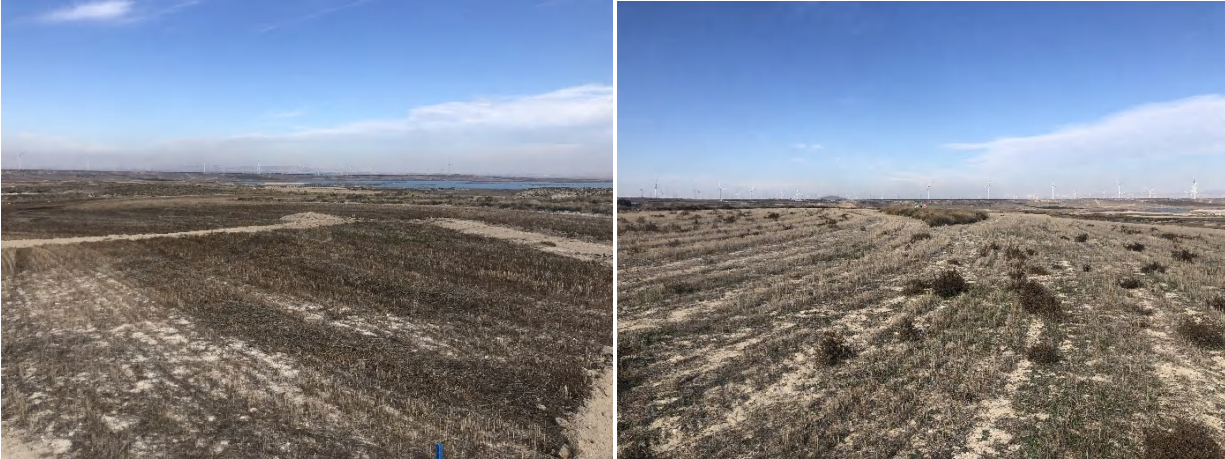
Foto 21. Estaquillado de las posiciones de los futuros viales y plataformas del parque (4/11/2021).
