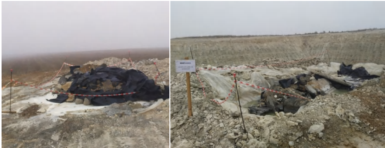
Foto 33. Residuos de hormigón almacenados en las piscinas de lavado de las plataformas.
