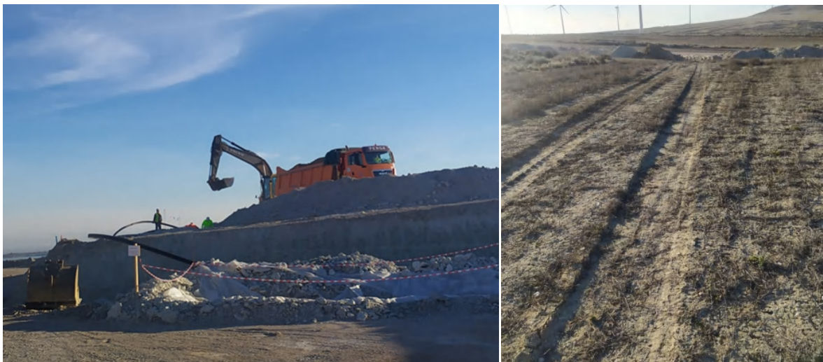
Foto 8. Fotografías del talud elevado que impedía el acceso a la maquinaria de obra (izquierda) y el acceso temporal (derecha) que se realizó desde el vial sur de acceso al aerogenerador 2. Fotografías del 3/2/2022.
