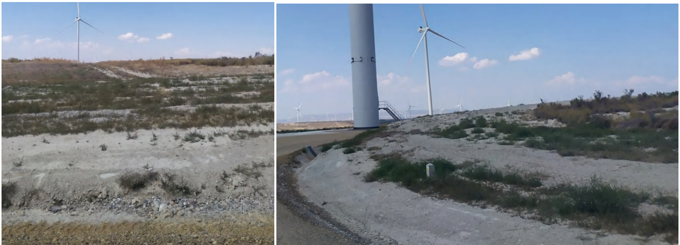
Foto 47. Ruta de acceso temporal a zona elevada de la plataforma del aerogenerador 3, en la que se tuvo que acceder con maquinaria por motivos logísticos y de seguridad para enterrar los cables de evacuación, restaurada con tierra vegetal y presentando revegetación natural.
