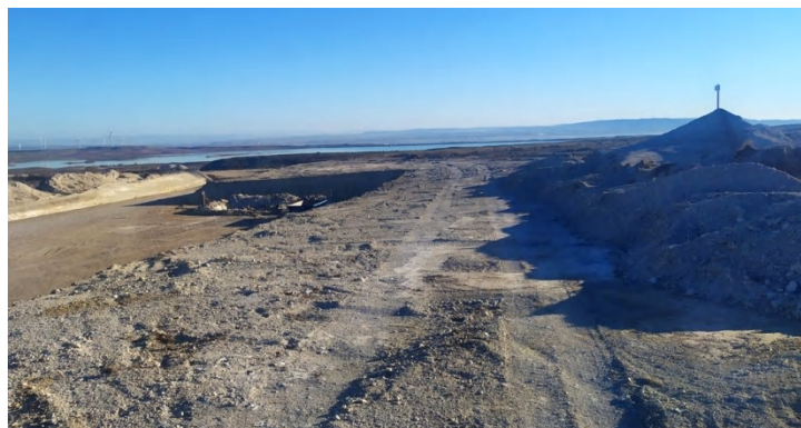
Foto 9. Parte superior del talud al sureste de la plataforma 2, ya terminadas las labores de enterramiento de cables y a punto de ser restaurado el 23 de febrero de 2022. Para la restauración se empleó el acopio de tierra vegetal que puede observarse a la derecha de la fotografía.
