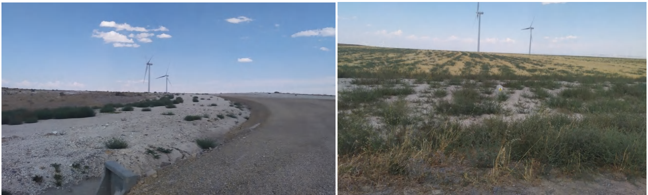
Foto 44. Superficie de los cables de evacuación del cruce de viales de aerogeneradores 3 y 2, así como el tramo del vial de acceso hacia el aerogenerador 3, restaurada y presentando una revegetación espontánea.
