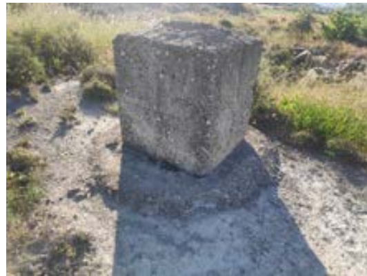
Figura 41: Estructura de hormigón del siglo XX en el trazado de la línea de evacuación
