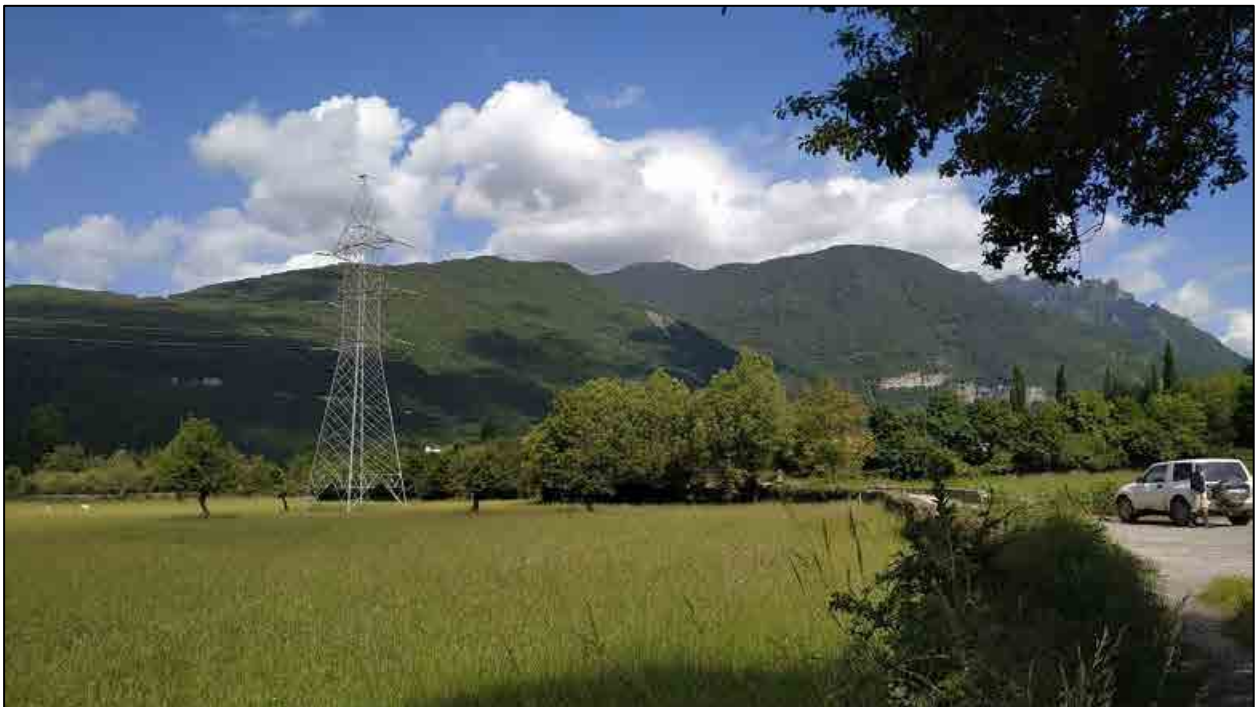
Apoyo de una línea de alta tensión de 220 kV en las cercanías de la SET Biescas 220 kV
