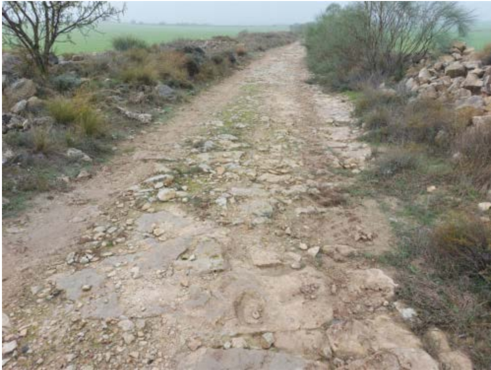
Figura. 6. Detalle del camino por donde está proyectado el trazado soterrado de la línea eléctrica de evacuación de 30 kV. Este tramo del camino está en peores condiciones que el resto de los caminos por donde discurre el trazado. A ambos lados del camino se observan grandes acumulaciones de piedras del despedregado y ejemplares de retama, tomillo, sisallo, esparto y algún almendro
