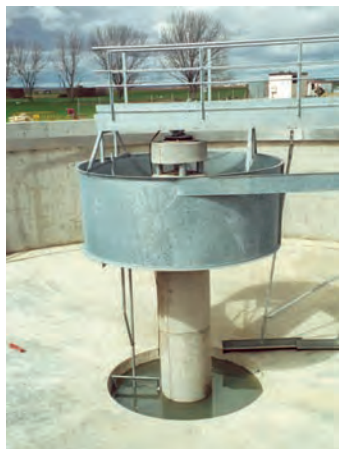
Figura 7.18. Entrada al decantador y cilindro deflector
