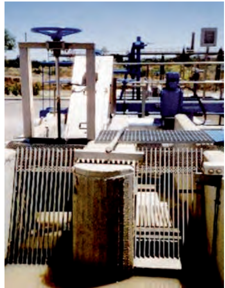
Figura 4.12. Pretratamiento con desbaste mediante reja manual de gruesos y tamiz, by-pass con reja manual de gruesos y desarenador-desengrasador aireado
