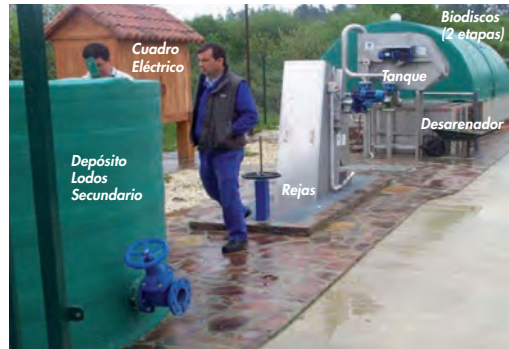
Figura 7.48. Pretratamiento mediante tamiz deslizante y sistema CBR
