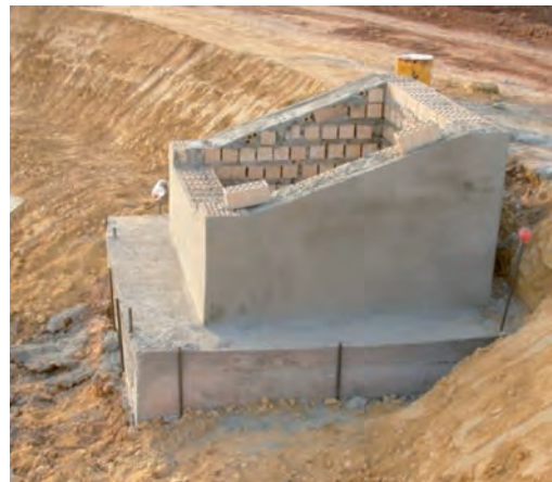
Figura 6.61. Arqueta de salida de una Laguna Facultativa
