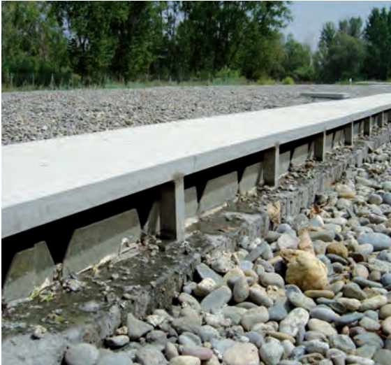
Figura 6.18. Reparto de la alimentación a un Humedal Artificial de Flujo Horizontal mediante vertedero Thompson (EDAR de Corbins, Lleida)
