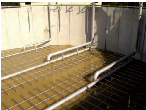
Figura 7.67. Detalle sistema aireación
