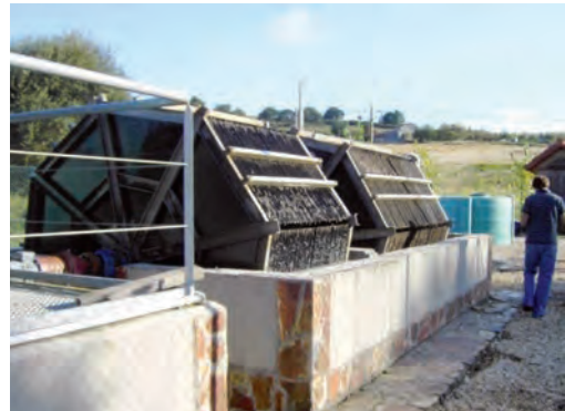
Figura 7.41. Sistema de biocilindros en Limiñón (La Coruña)
