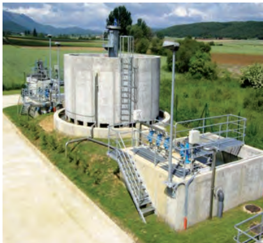
Figura 7.32. EDAR de Lechos Bacterianos. Bermeo (Vizcaya)
