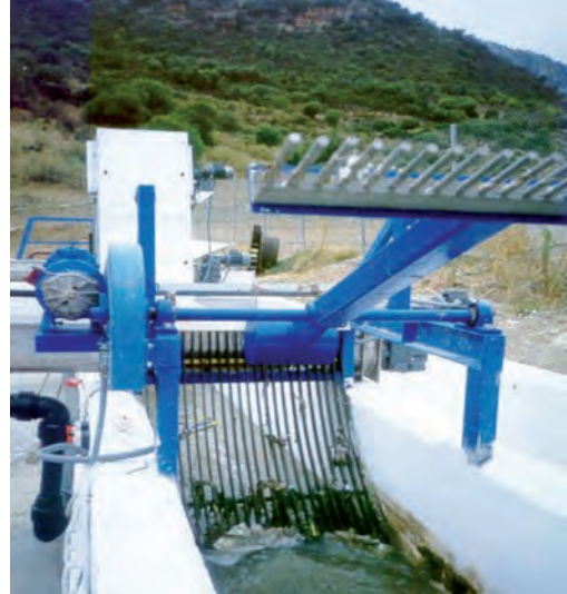
Figura 4.3. Reja de finos automática
