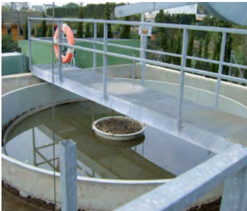
Figura 7.16. Decantador estático de flujo vertical. EDAR Monasterios, Sagunto (Valencia)
