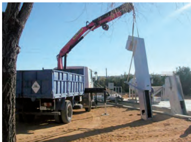
Figura 4.27. Montaje de un tamiz deslizante en una pequeña depuradora
