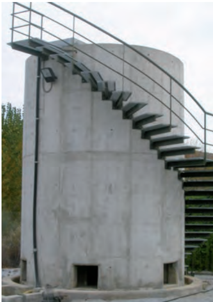
Figura 7.25. Ventanas inferiores de ventilación de un Lecho Bacteriano
