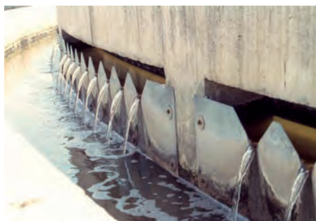
Figura 7.19. Vertedero de salida del decantador
