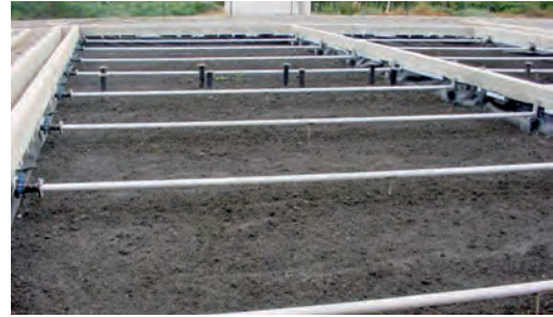
Figura 6.50. Tuberías para alimentación de un Filtro de Turba
