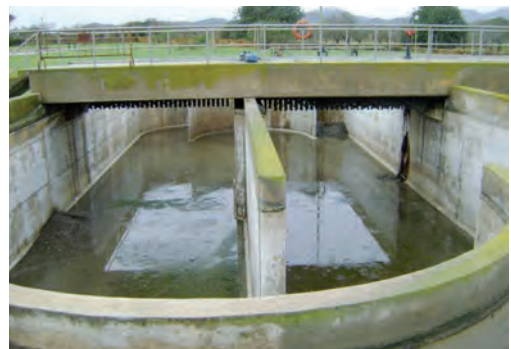
Figura 7.4. Canal de oxidación. EDAR Porto Colom-Felanitx (Islas Baleares)
