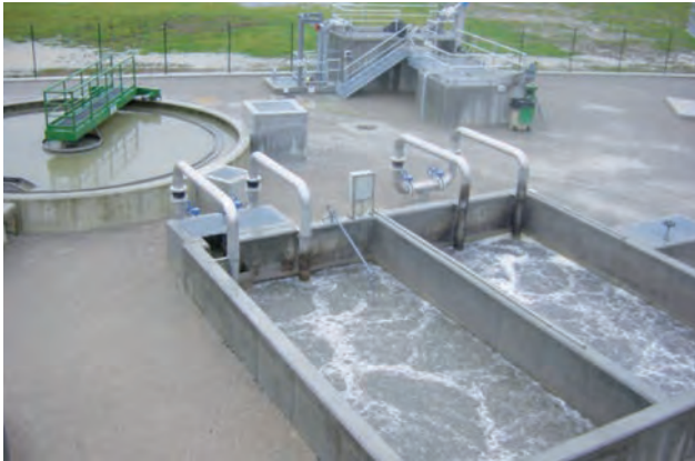
Figura 7.65. Reactor MBBR en obra civil. EDAR de Lekumberri
