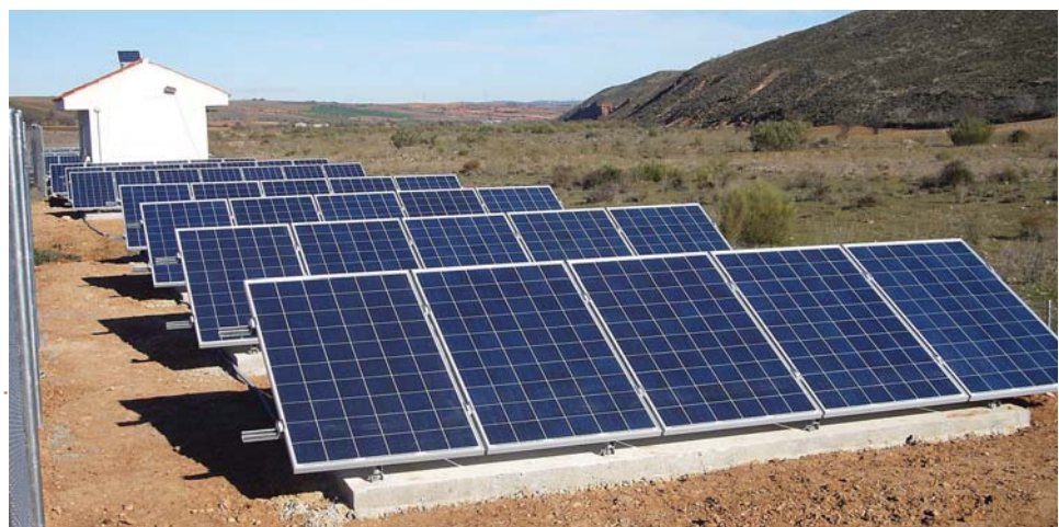
Fotografía 15.3-2. Instalación solar de 14,2 kW para abastecimiento de agua (Villar de los Navarros, Zaragoza)
