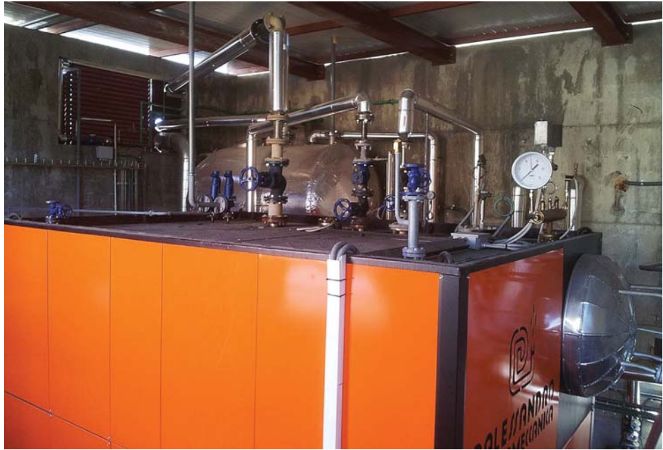
Fotografía 5.2-3. Caldera vapor con biomasa, 1.395 kW (Villamayor, Zaragoza)
