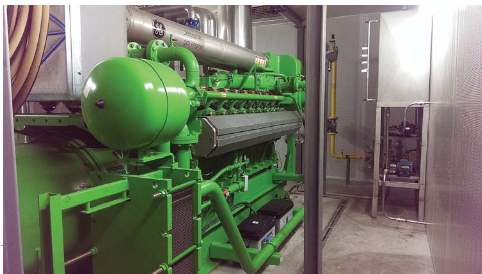
Fotografía 8.2-1. Central de trigeneración de 1MW (Mallén,Zaragoza)
