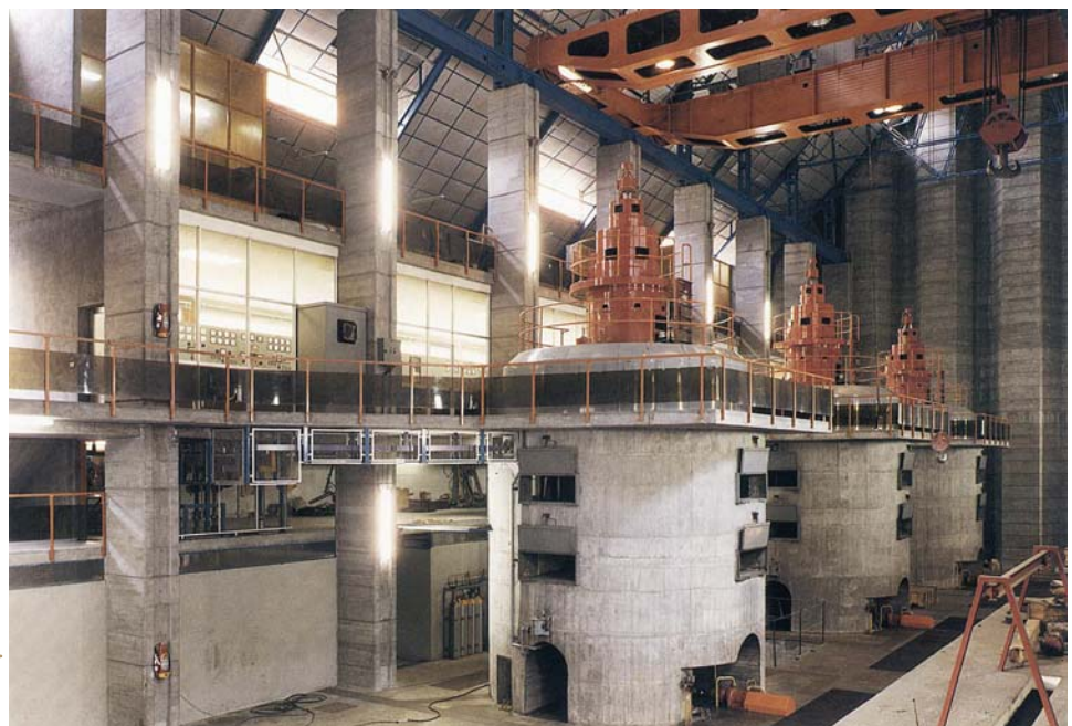
Fotografía 5.2-1. Central hidroeléctrica de 84MW (Canfranc, Huesca)
