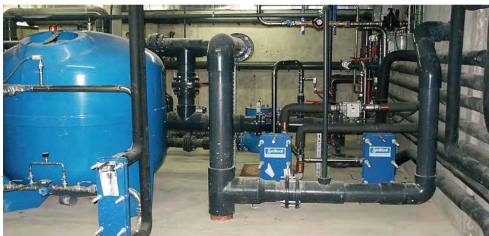
Fotografía 7.2-2. Instalación geotérmica para climatización en centro deportivo de 100 kW (Zaragoza)
