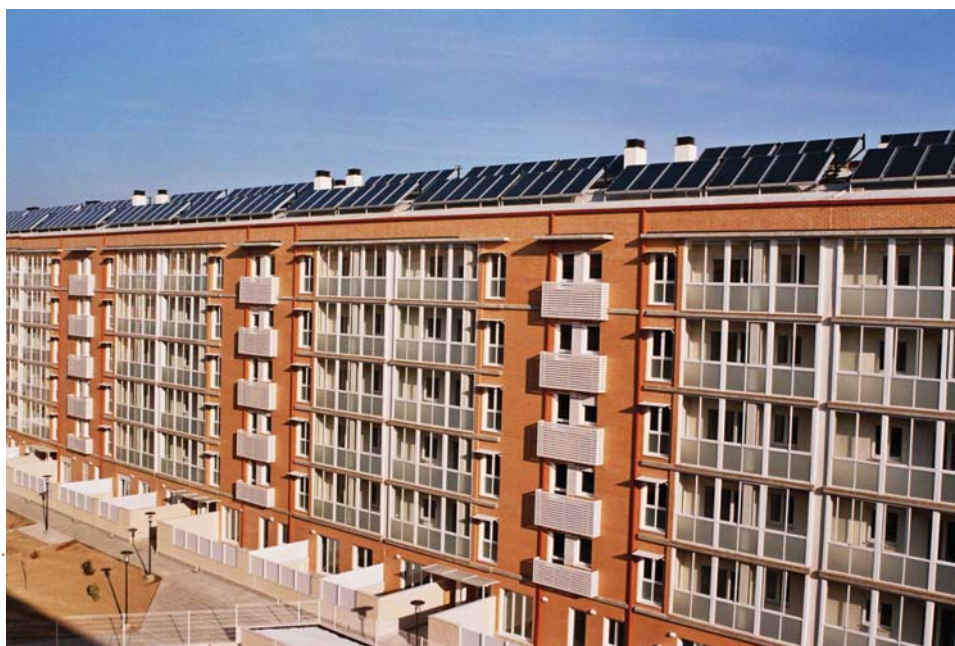
Fotografía 9.3-3. Instalación solar térmica 320 viviendas en Parque Goya (Zaragoza)
