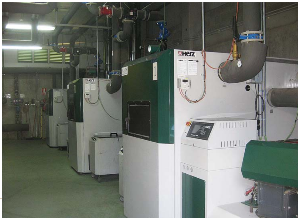
Fotografía 7.2-1. Calderas biomasa 3x500 kW (Alagón, Zaragoza)
