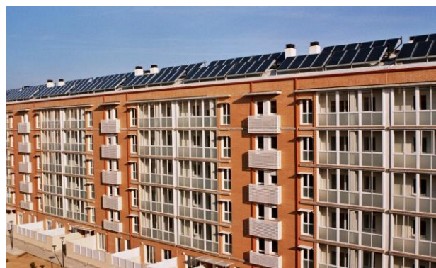
Instalación solar térmica residencial en Parque Goya (Zaragoza)
