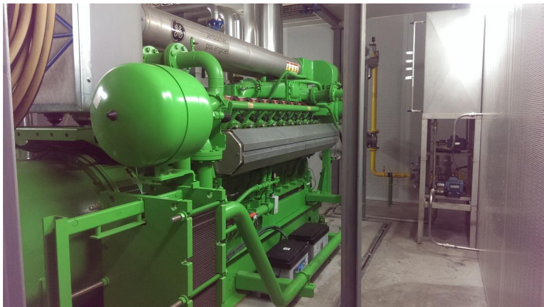
Central de Trigeneración de Solutex (Mallén, Zaragoza)
