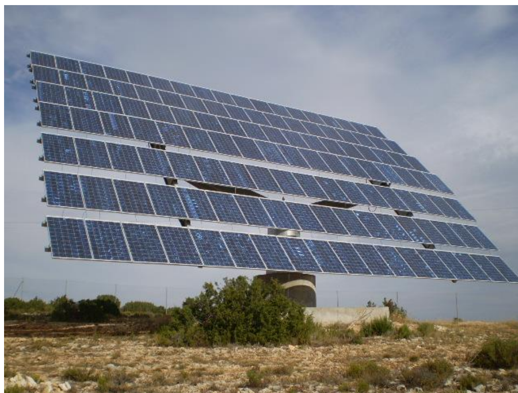
Planta solar fotovoltaica en Fuentetodos (Zaragoza)
