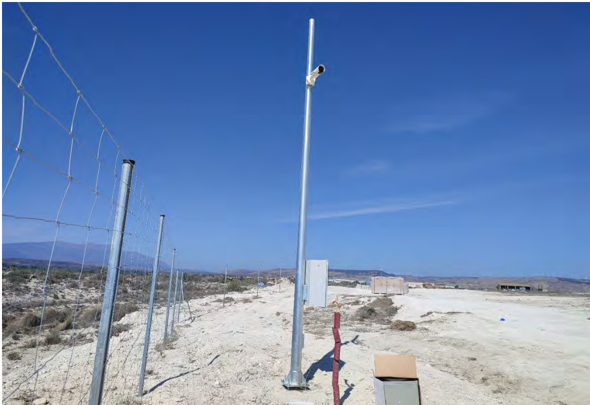
Fotografía 10. Sistema de videovigilancia.
